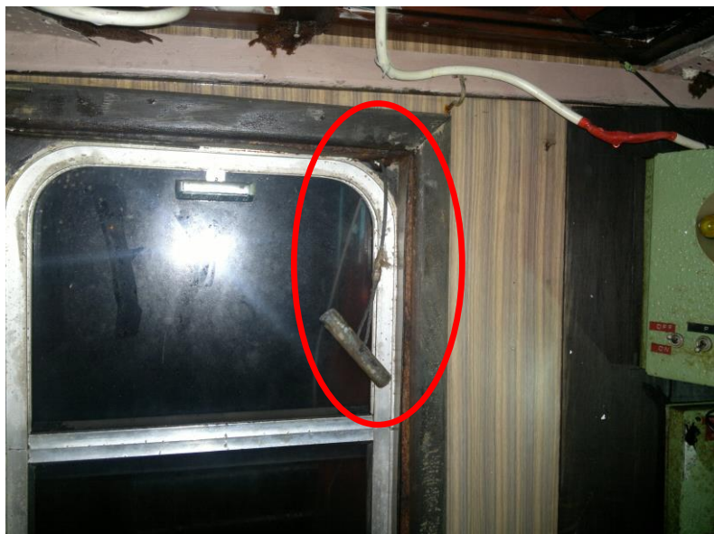
Εικόνα 9: Η χειρολαβή απασφάλισης του συστήματος άμεσης απελευθέρωσης ρυμουλκίου στο χώρο πηδαλιουχίας του ΑΡΤΕΜΙΣ V.
